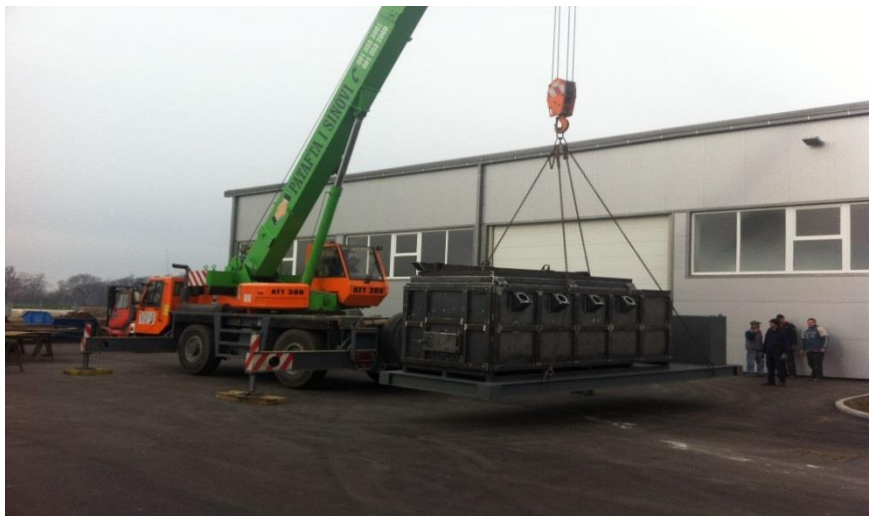
Abbildung 2 Abfallverbrennungsanlage/ für INCINER 8
